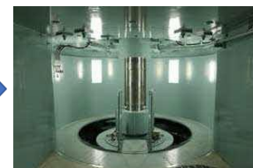
新発電機内部 54100kW
