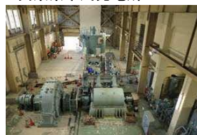
既設発電機 (100年前に設置) 51200kW
